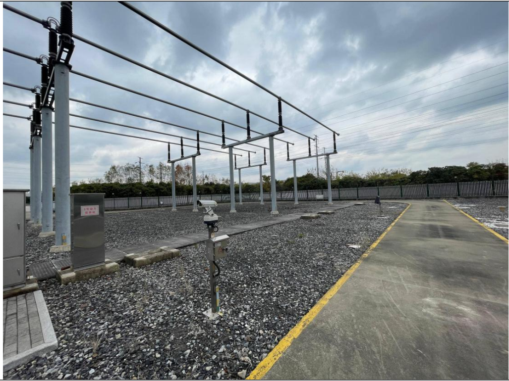
220kV预留出线间隔现状
