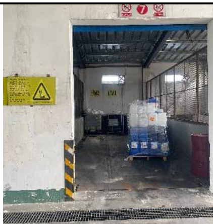
3-3 危废库地面防腐防渗、有泄漏收集沟
