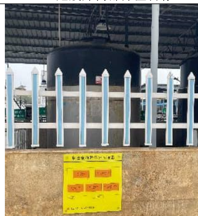
1-3 危废罐区分区暂存
